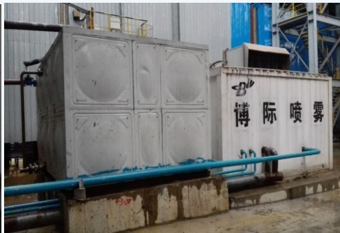
日照钢铁烟气降温装置泵站
