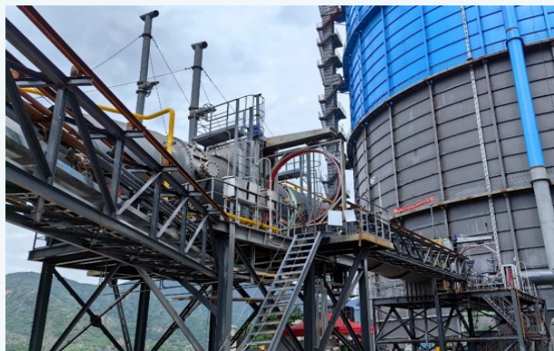
云南仙福钢铁高炉煤气入口降温装置
