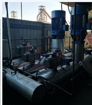
包钢炉顶打水装置泵站
