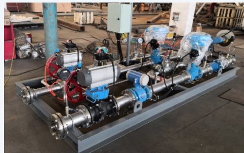
包钢炉顶打水装置阀站
