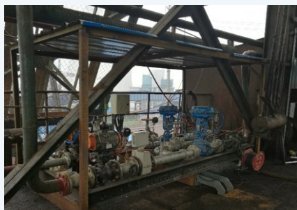
马钢炉顶打水装置阀站
