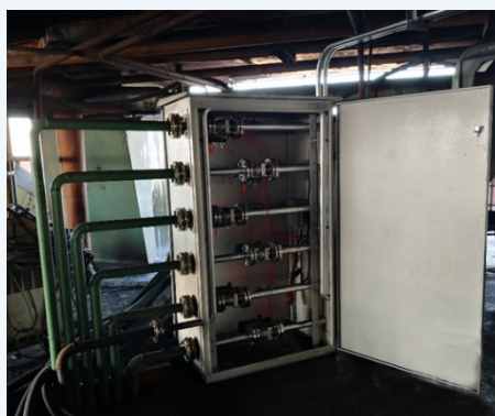
沙钢炉顶打水装置分流柜
