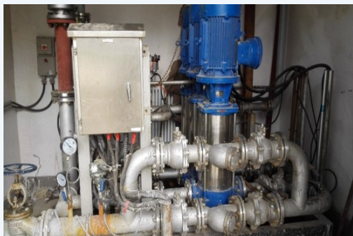
包钢烟气降温装置泵站
