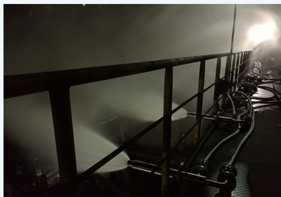
酒钢炉顶打水装置现场
