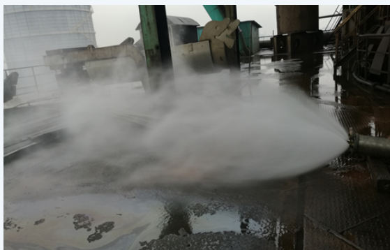
马钢B高炉炉顶打水装置现场
