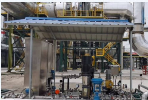
中天精品钢烟气降温装置泵站
