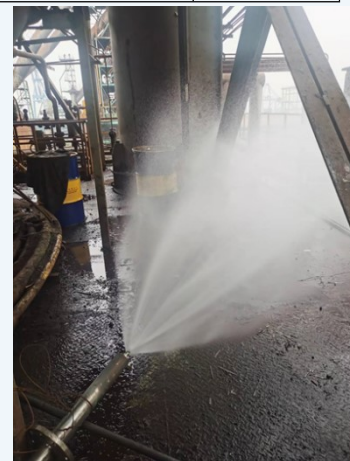
沙钢炉顶打水装置现场
