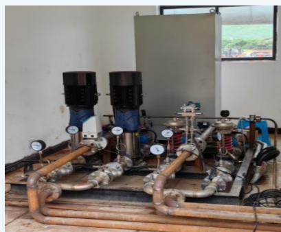
仙福烟气降温装置泵站
