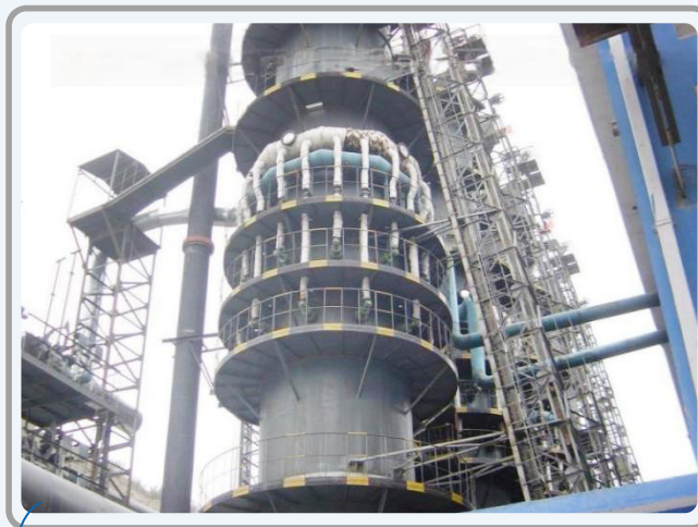
● 石灰窑G型燃气燃烧器 西宁特钢生产现场
