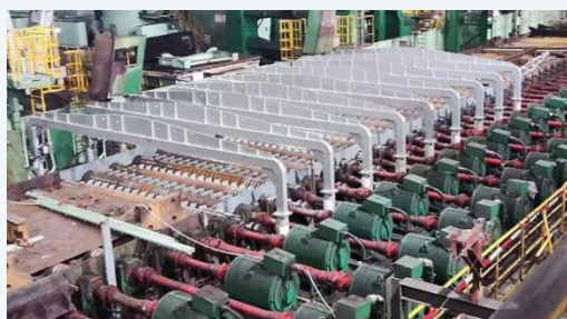
宝钢宽厚板中间坯冷却喷梁
