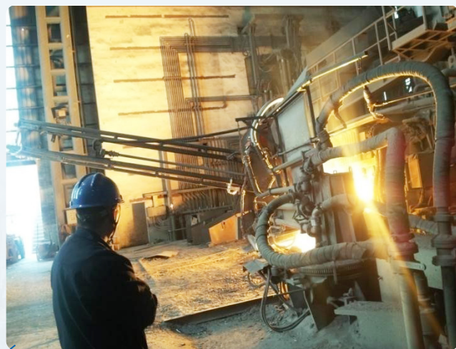
● 全套自耗式炉门氧枪系统（福建鼎信镍业现场）
