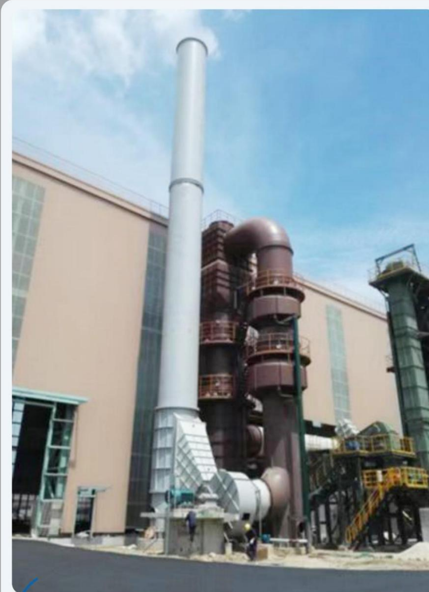
● 宝钢湛江铸余渣钢渣处理 2#渣处理
