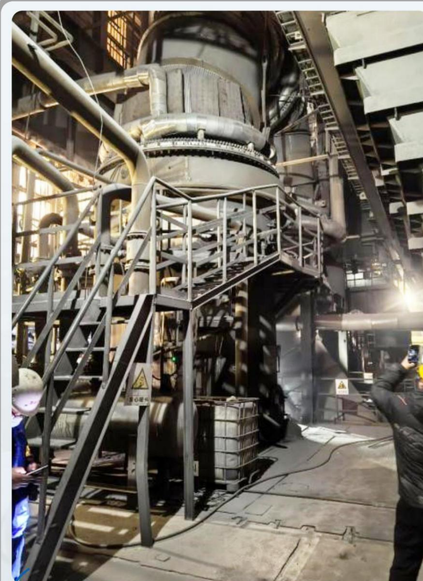
● 中铁转炉煤气一次湿法除尘
