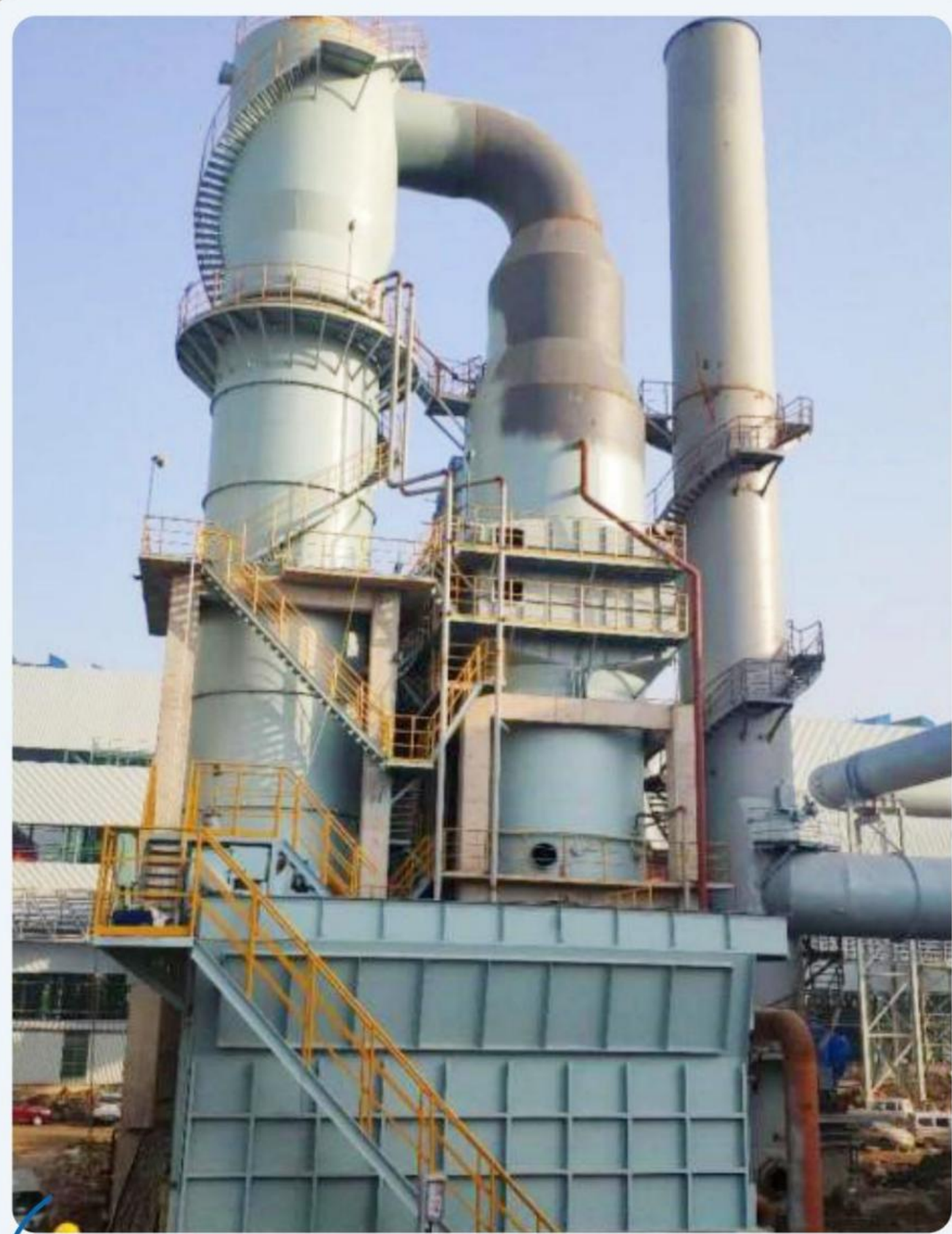
● 唐山丰南纵横炼钢厂一、二车间钢渣处理喷淋除尘系统
