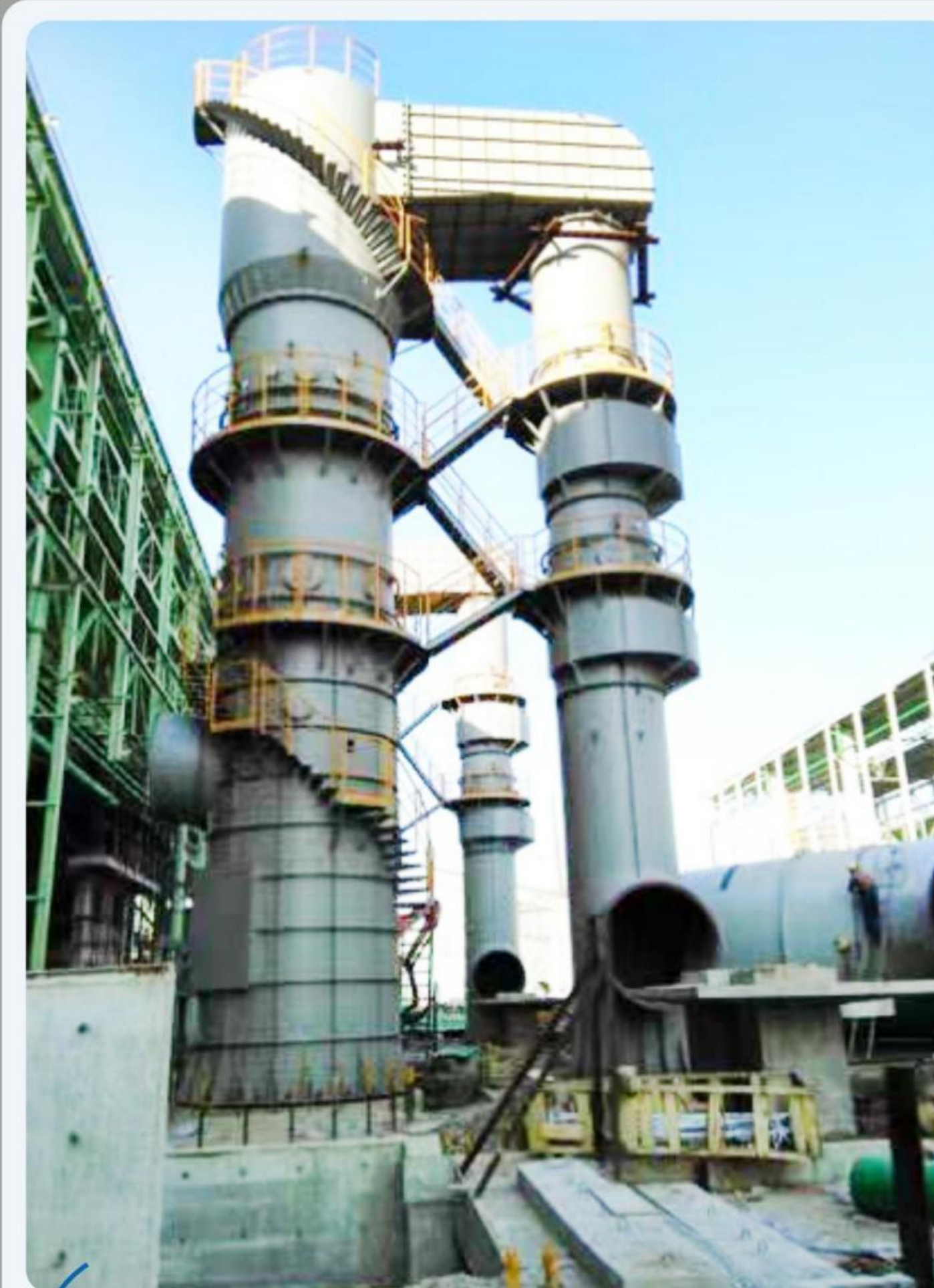
● 青岛钢铁二期续建渣处理 湿式变流除尘系统及 湿电超低排放系统
