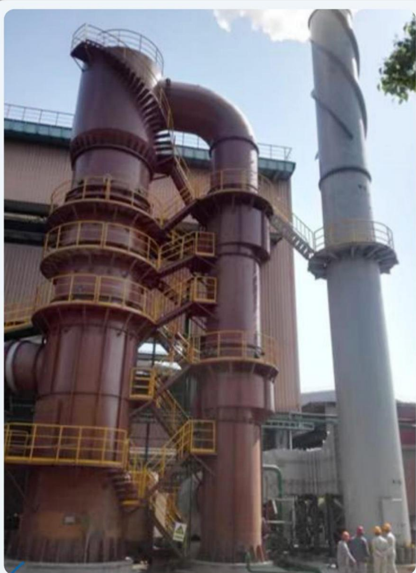
● 梅山钢铁一炼钢渣处理 渣处理湿式变流除尘系统
