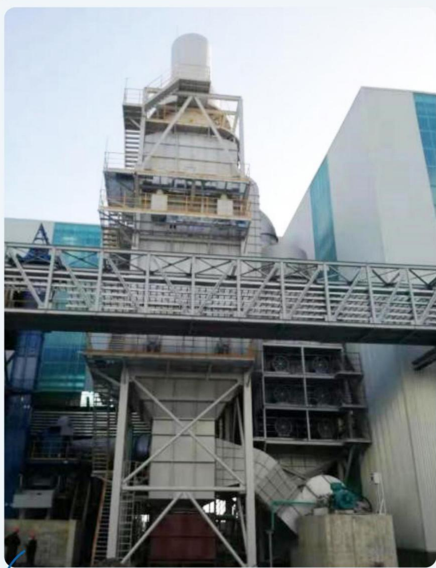
● 山东莱钢永锋1#、2#钢渣处理湿式变流除尘及湿式电除尘超低排放系统+烟羽脱白系统
